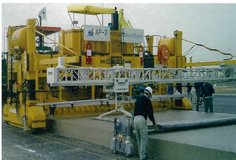
写真6 スリップフォームペーバによるコンクリートの締固め状況の例
