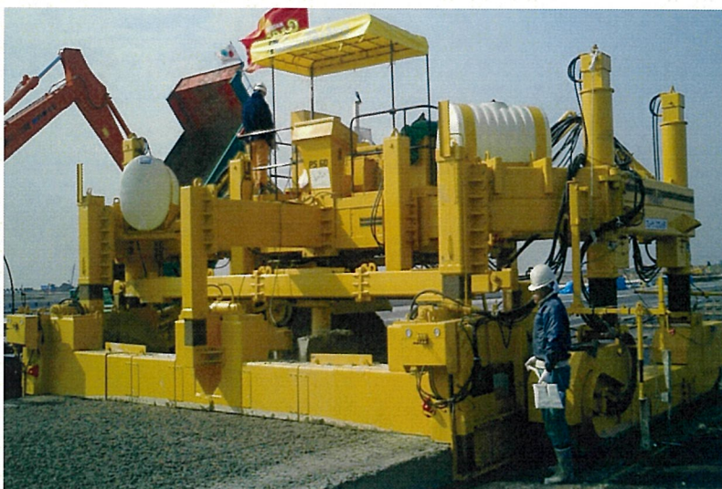
写真3 スリップフォームスプレッダによる下層コンクリート敷均し状況の例
