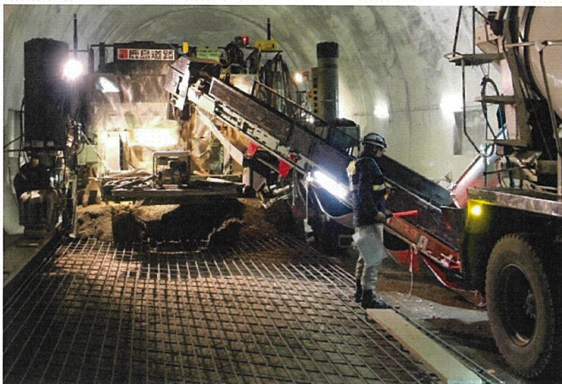
写真12 舗装用中型機によるトンネル内舗設状況の例（ベルコン付）
