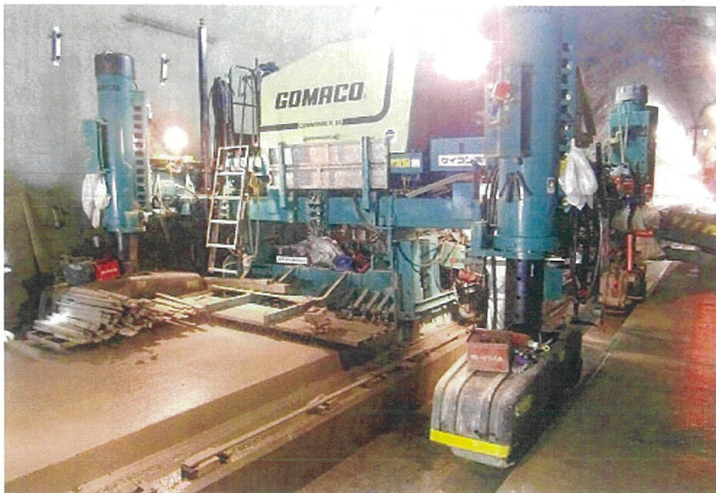
写真一1 成型機の外観
